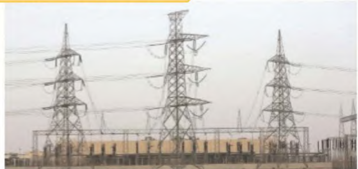
محطة سدير لتحويل الكهرباء
